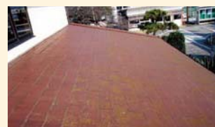
既存の屋根材は化粧スレートで、塗装を何回か繰り返しています。コケが所々に生えていました。
