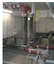
複数配管設置例
